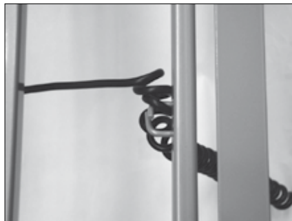
Leitungsführung des Motors des Fußendes.
