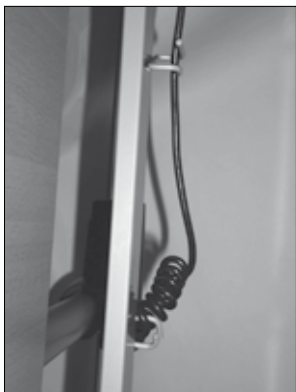
Leitungsführung Hubmotor, Kopfende.
