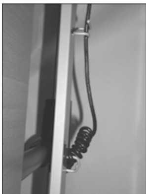
Cablaggio del motore di sollevamento testiera.
